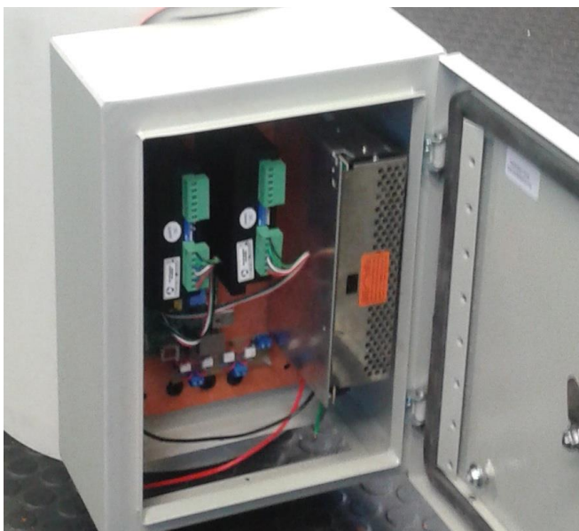
Figura 43 – Caixa de Comando
