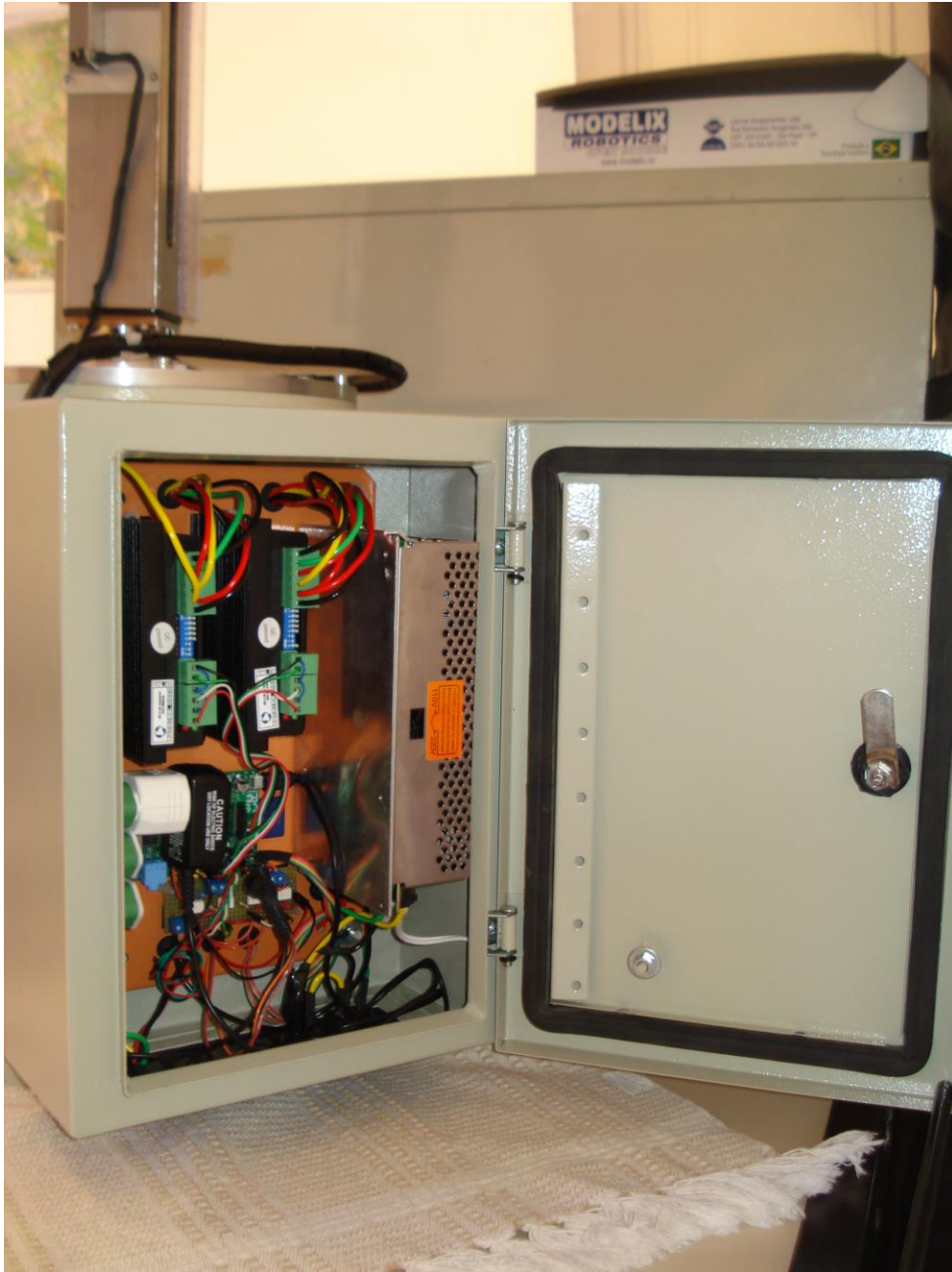
Foto caixa de comando Montada
