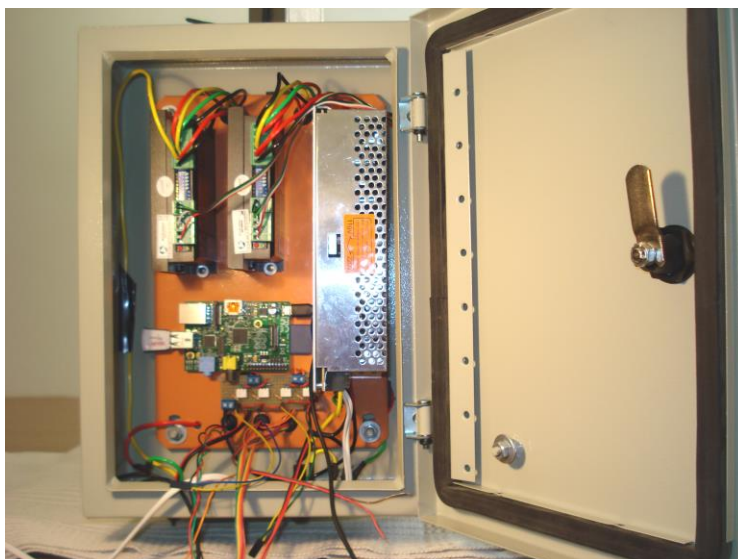
Figura 8 – Caixa de Comando
