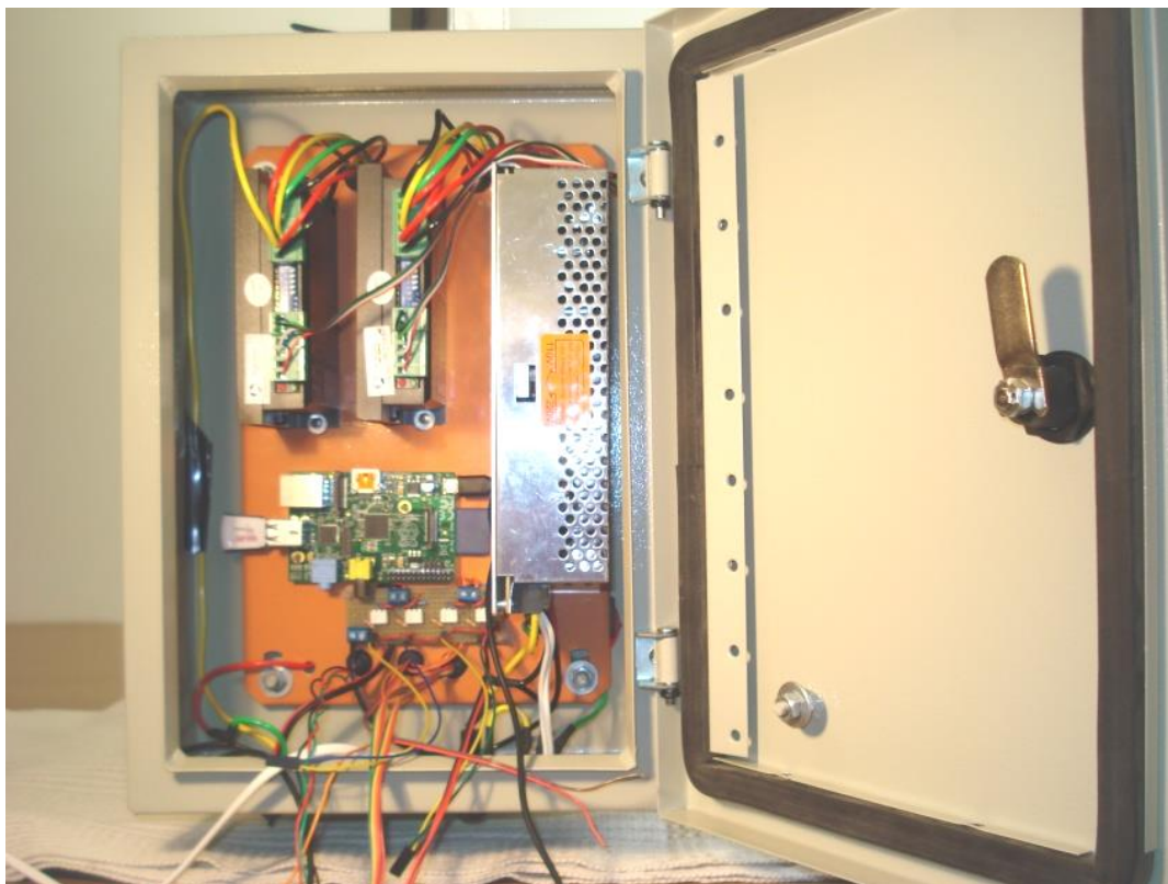
Figura 4.5 - Caixa de comando.
